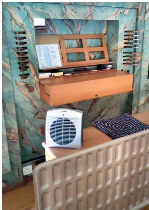
Brandgefährlich: Im August 2022 in einer Schweizer Kirche des 15. Jahrhunderts mit einer Orgel von Josef Anton Moser (1784) so angetroffen: ein mobiler Kleinlüfter und eine Elektroheizung direkt an bzw. auf der Orgelbank.
